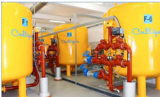
Hala filtrów SUW Sobików
